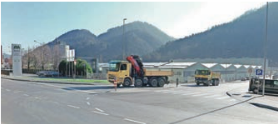
V Poslovni coni Alples so preuredili slabo pregledno križišče ob uvozu v cono in obnovili več odsekov vodovoda.
